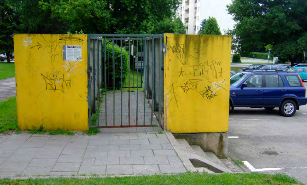
unzureichende Gestaltung Müllplätze
